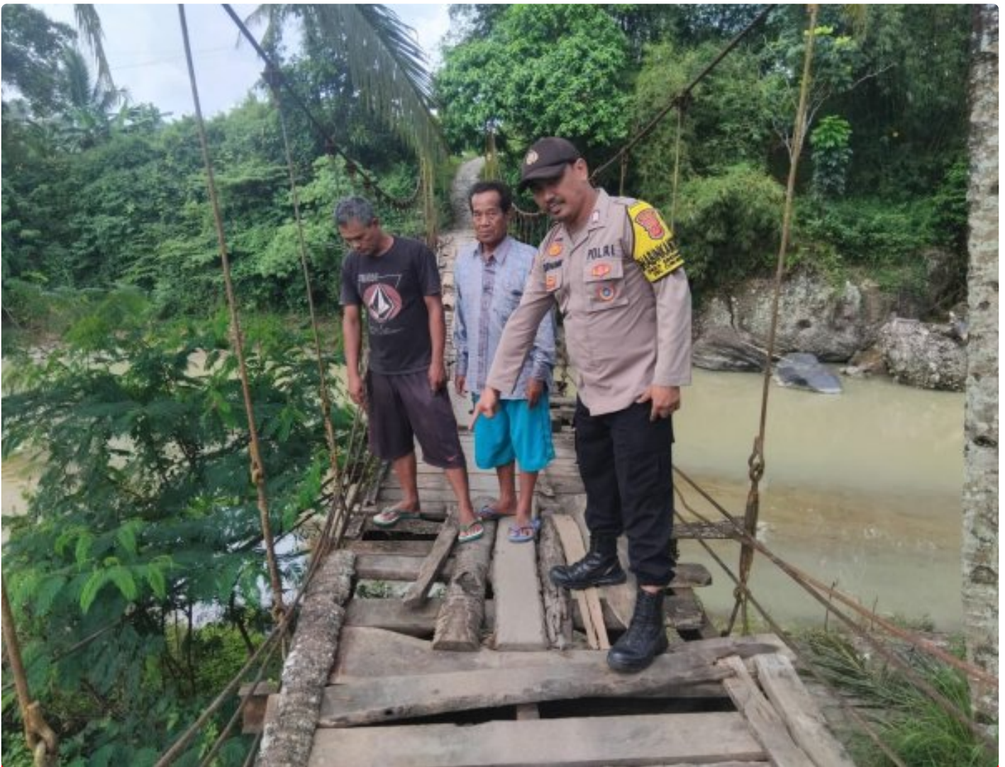
Warga Terjatuh dari Jembatan Gantung di Curugkembar, Polisi Imbau Warga Waspada
